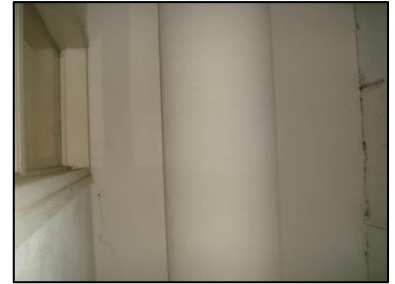
Photo N° 5772 AMIANTE CIMENT 2 COUPERIN-LOCAL V.O +1 à +4 Vide-ordures Gaine V.O.(Fibres- ciment)
