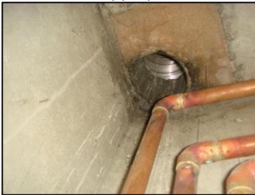
Photo N° 5773 AMIANTE CIMENT 2 COUPERIN-PLACARDS GAZ +4 Plafonds Ventilation haute (Fibres- ciment)
