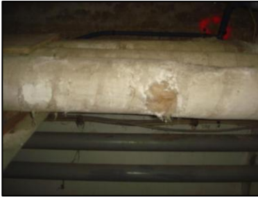
Photo N° 5770 ECH-N°16 CALORIFUGEAGE 2 COUPERIN-S- SOL COULOIRS DE CAVES Conduits de fluide Laine minérale + enveloppe plâtrée
