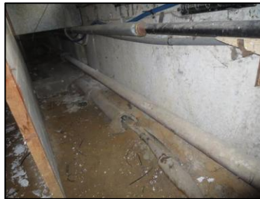
Photo N° 729 AMIANTE CIMENT 1 COUPERIN-S.sol-COULOIRS DE CAVES Planchers Chute E.U.(Fibres-ciment)
