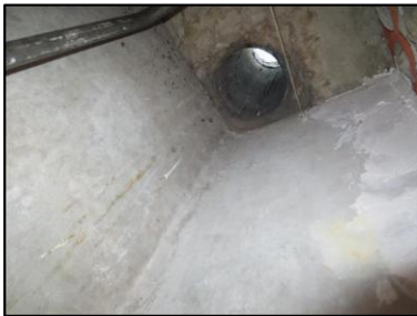
Photo N° 704 AMIANTE CIMENT 1 COUPERIN--PLACARDS GAZ +4 Plafonds Ventilation haute (Fibres- ciment)
