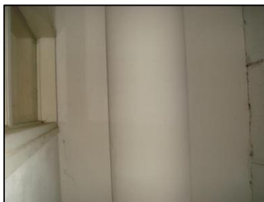
Photo N° 5772 AMIANTE CIMENT 4 COUPERIN--LOCAL V.O RDC à +4 Vide-ordures Gaine V.O.(Fibres- ciment)
