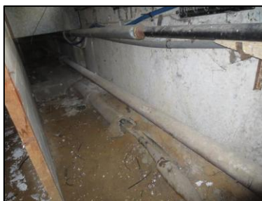
Photo N° 729 AMIANTE CIMENT 5 COUPERIN-S.sol-COULOIRS DE CAVES Planchers Chute E.U.(Fibres-ciment)
