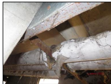
Photo N° 730 AMIANTE CIMENT 5 COUPERIN--LOCAL V.O RDC à +4 Vide-ordures Gaine V.O.(Fibres- ciment)
