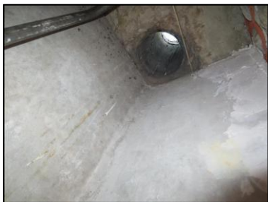
Photo N° 704 AMIANTE CIMENT 5 COUPERIN--PLACARDS GAZ +4 Plafonds Ventilation haute (Fibres- ciment)
