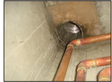
Photo N° 5773 AMIANTE CIMENT 6 COUPERIN--PLACARDS GAZ +4 Plafonds Ventilation haute (Fibres- ciment)
