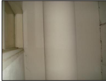
Photo N° 5772 AMIANTE CIMENT 6 COUPERIN--LOCAL V.O RDC à +4 Vide-ordures Gaine V.O.(Fibres- ciment)
