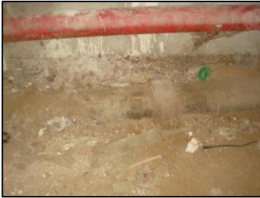
Photo N° 5771 AMIANTE CIMENT 6 COUPERIN-S.sol-COULOIRS DE CAVES Conduits de fluide Chute E.U.(Fibres-ciment)
