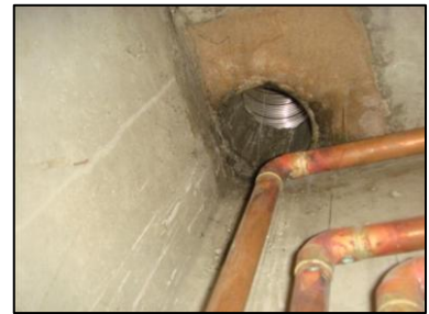
Photo N° 5773 AMIANTE CIMENT 8 COUPERIN--PLACARDS GAZ +4 Plafonds Ventilation haute (Fibres- ciment)
