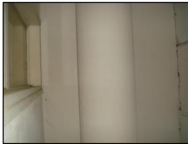
Photo N° 5772 AMIANTE CIMENT 8 COUPERIN--LOCAL V.O RDC à +4 Vide-ordures Gaine V.O.(Fibres- ciment)
