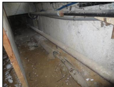
Photo N° 729 AMIANTE CIMENT 7 COUPERIN-S.sol-COULOIRS DE CAVES Planchers Chute E.U.(Fibres-ciment)
