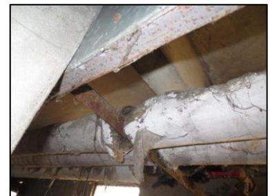
Photo N° 730 AMIANTE CIMENT 7 COUPERIN--LOCAL V.O RDC à +4 Vide-ordures Gaine V.O.(Fibres- ciment)
