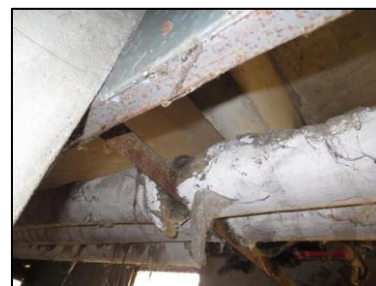
Photo N° 730 AMIANTE CIMENT 7 COUPERIN--LOCAL V.O RDC à +4 Vide-ordures Gaine V.O.(Fibres- ciment)
