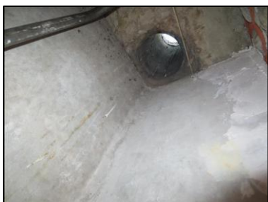
Photo N° 704 AMIANTE CIMENT 7 COUPERIN--PLACARDS GAZ +4 Plafonds Ventilation haute (Fibres- ciment)
