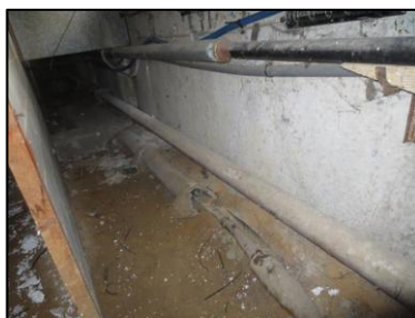
Photo N° 729 AMIANTE CIMENT 7 COUPERIN-S.sol-COULOIRS DE CAVES Planchers Chute E.U.(Fibres-ciment)
