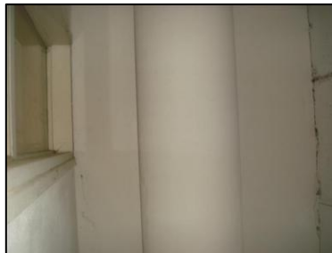
Photo N° 5772 AMIANTE CIMENT 10 COUPERIN--LOCAL V.O RDC à +4 Vide-ordures Gaine V.O.(Fibres- ciment)
