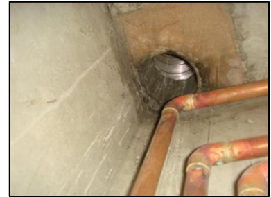
Photo N° 5773 AMIANTE CIMENT 10 COUPERIN--PLACARDS GAZ +4 Plafonds Ventilation haute (Fibres-ciment)
