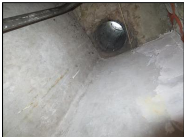
Photo N° 704 AMIANTE CIMENT 11 COUPERIN--PLACARDS GAZ +4 Plafonds Ventilation haute (Fibres- ciment)
