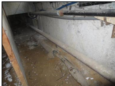
Photo N° 729 AMIANTE CIMENT 11 COUPERIN-S.sol-COULOIRS DE CAVES Planchers Chute E.U.(Fibres-ciment)
