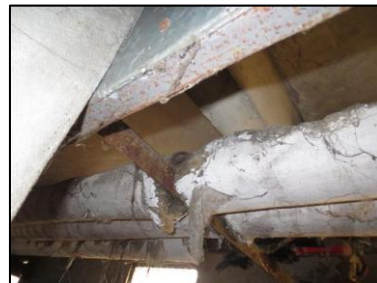
Photo N° 730 AMIANTE CIMENT 11 COUPERIN--LOCAL V.O RDC à +4 Vide-ordures Gaine V.O.(Fibres- ciment)
