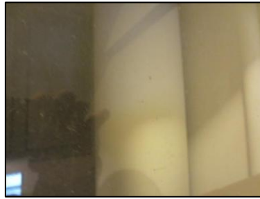
Photo N° 703 AMIANTE CIMENT 1 COUPERIN-LOCAL V.O +1 à +4 Vide-ordures Gaine V.O.(Fibres- ciment)
