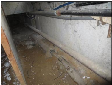
Photo N° 729 AMIANTE CIMENT 1 COUPERIN-S.sol-COULOIRS DE CAVES Planchers Chute E.U.(Fibres-ciment)
