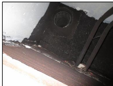
Photo N° 710 AMIANTE CIMENT 20 BLAISE--PLACARDS GAZ +4 Plafonds Ventilation haute (Fibres-ciment)
