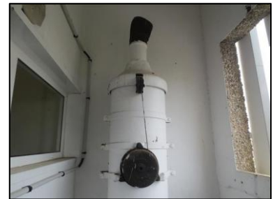
Photo N° 711 AMIANTE CIMENT 20 BLAISE--LOCAL V.O RDC à +4 Vide-ordures Gaine V.O.(Fibres- ciment)
