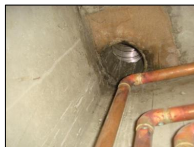
Photo N° 5773 AMIANTE CIMENT 12 COUPERIN--PLACARDS GAZ +4 Plafonds Ventilation haute (Fibres-ciment)
