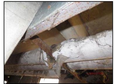
Photo N° 730 AMIANTE CIMENT 13 COUPERIN--LOCAL V.O RDC à +4 Vide-ordures Gaine V.O.(Fibres- ciment)
