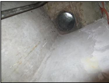
Photo N° 704 AMIANTE CIMENT 13 COUPERIN--PLACARDS GAZ +4 Plafonds Ventilation haute (Fibres- ciment)
