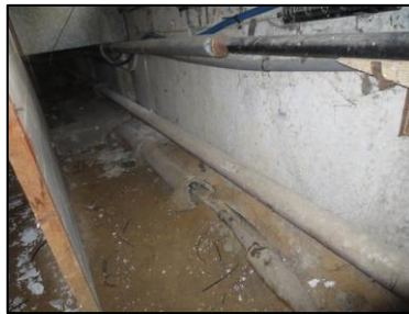
Photo N° 729 AMIANTE CIMENT 13 COUPERIN-S.sol-COULOIRS DE CAVES Planchers Chute E.U.(Fibres-ciment)
