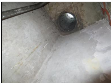
Photo N° 704 AMIANTE CIMENT 13 COUPERIN--PLACARDS GAZ +4 Plafonds Ventilation haute (Fibres- ciment)
