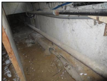
Photo N° 729 AMIANTE CIMENT 13 COUPERIN-S.sol-COULOIRS DE CAVES Planchers Chute E.U.(Fibres-ciment)
