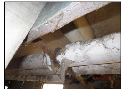
Photo N° 730 AMIANTE CIMENT 15 COUPERIN--LOCAL V.O RDC à +4 Vide-ordures Gaine V.O.(Fibres-ciment)
