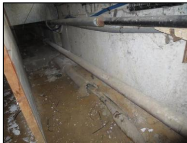
Photo N° 729 AMIANTE CIMENT 15 COUPERIN--S.sol-COULOIRS DE CAVES Planchers Chute E.U.(Fibres-ciment)
