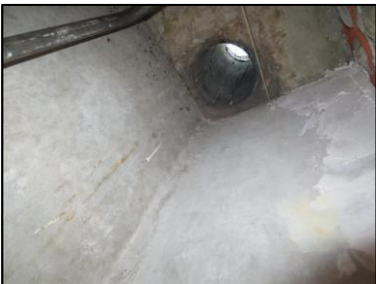
Photo N° 704 AMIANTE CIMENT 15 COUPERIN--PLACARDS GAZ +4 Plafonds Ventilation haute (Fibres-ciment)
