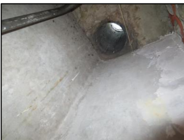
Photo N° 704 AMIANTE CIMENT 17 COUPERIN--PLACARDS GAZ +4 Plafonds Ventilation haute (Fibres-ciment)
