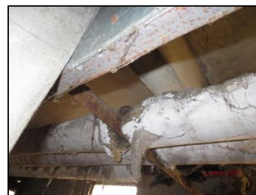
Photo N° 730 AMIANTE CIMENT 17 COUPERIN--LOCAL V.O RDC à +4 Vide-ordures Gaine V.O.(Fibres-ciment)
