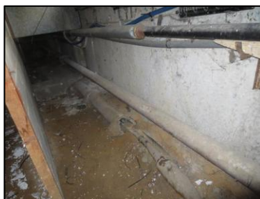
Photo N° 729 AMIANTE CIMENT 17 COUPERIN-S.sol-COULOIRS DE CAVES Planchers Chute E.U.(Fibres-ciment)
