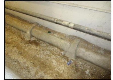
Photo N° 693 AMIANTE CIMENT 1 ST EXUP-S.sol-COULOIRS DE CAVES Conduits de fluide Chute E.U.(Fibres-ciment)
