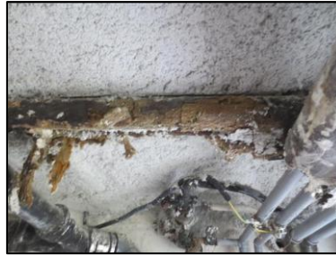
Photo N° 692 ECH-N°04 CALORIFUGEAGE 1 ST EXUP- S.sol-DEBARRAS 2 Conduits de fluide Laine minérale + enveloppe plâtrée
