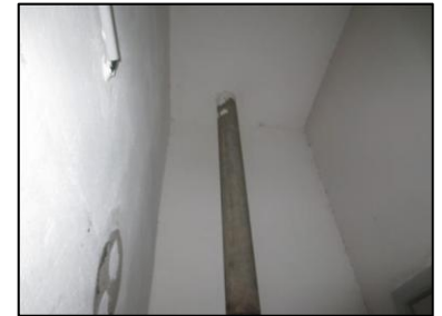
Photo N° 697 AMIANTE CIMENT 1 ST EXUP- +4-LOCAL V.O Vide- ordures Ventilation haute (Fibres- ciment)
