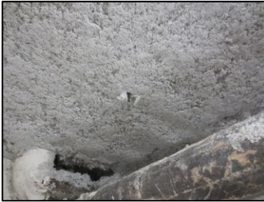
Photo N° 691 ECH-N°1 FLOCAGE 1 ST EXUP-S.sol-DEBARRAS 1 Plafonds flocage
