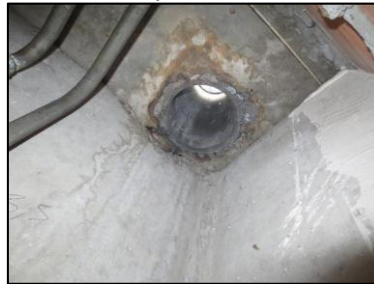
Photo N° 696 AMIANTE CIMENT 1 ST EXUP- +4-PLACARDS GAZ Plafonds Ventilation haute (Fibres- ciment)
