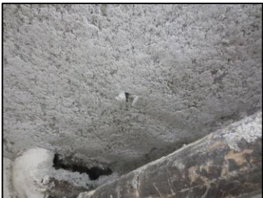
Photo N° 691 ECH-N°1 FLOCAGE 1 ST EXUP-S.sol-DEBARRAS 1 Plafonds flocage
