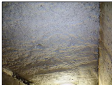
Photo N° 72 ECH-N°1 FLOCAGE Sous Sol Plafonds Cotonneux blanc
