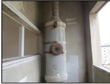
Photo N° 65 AMIANTE CIMENT Local vide ordure du 1er au 4ème Vide-ordures Gaine V.O. (Fibres-ciment)
