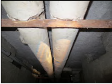
Photo N° 106 ECH-N°2 CALORIFUGEAGE 1-Sous Sol_1 Conduits de fluide Laine minérale + enveloppe plâtrée
