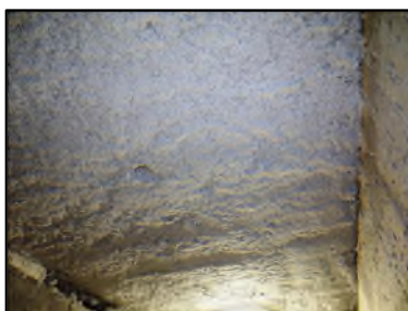
Photo N° 72 ECH-N°1 FLOCAGE Sous Sol Plafonds Cotonneux blanc
