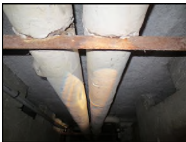
Photo N° 106 ECH-N°2 CALORIFUGEAGE 1-Sous Sol_1 Conduits de fluide Laine minérale + enveloppe plâtrée
