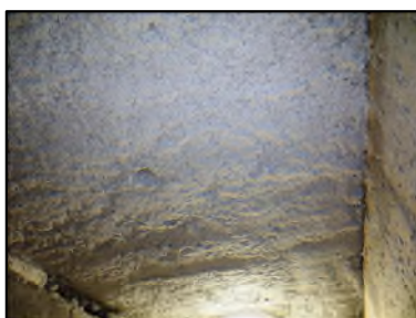
Photo N° 72 ECH-N°1 FLOCAGE Sous Sol Plafonds Cotonneux blanc
