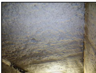
Photo N° 72 ECH-N°1 FLOCAGE Sous Sol Plafonds Cotonneux blanc
