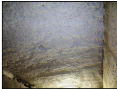
Photo N° 72 ECH-N°1 FLOCAGE Sous Sol Plafonds Cotonneux blanc
