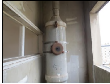
Photo N° 65 AMIANTE CIMENT Local vide ordure du 1er au 4ème Vide-ordures Gaine V.O.(Fibres-ciment)
