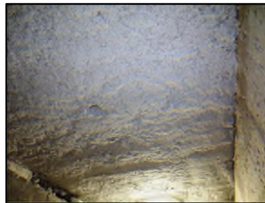
Photo N° 72 ECH-N°1 FLOCAGE 1-S.sol Plafonds Cotonneux blanc
