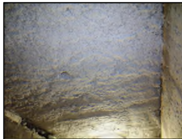
Photo N° 72 ECH-N°1 FLOCAGE 1-S.sol Plafonds Cotonneux blanc
