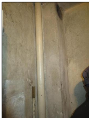
Photo N° 686 AMIANTE CIMENT 3 LORIENT--LOCAL V.O +7 à +8 Conduits de fluide Chute E.P.(Fibres-ciment)
