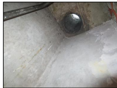
Photo N° 704 AMIANTE CIMENT 3 LORIENT--PLACARDS GAZ +8 Plafonds Ventilation haute (Fibres- ciment)
