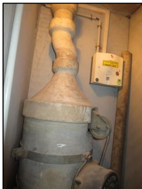
Photo N° 799 AMIANTE CIMENT 4 LORIENT--LOCAL V.O +1 à +8 Vide-ordures Gainé V.O.(Fibres- ciment)
