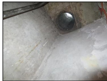
Photo N° 704 AMIANTE CIMENT 5 LORIENT--PLACARDS GAZ +8 Plafonds Ventilation haute (Fibres- ciment)
