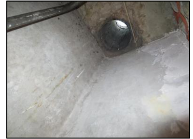
Photo N° 704 AMIANTE CIMENT 6 LORIENT--PLACARDS GAZ +8 Plafonds Ventilation haute (Fibres- ciment)
