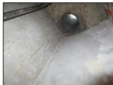
Photo N° 704 AMIANTE CIMENT 6 LORIENT--PLACARDS GAZ +8 Plafonds Ventilation haute (Fibres- ciment)
