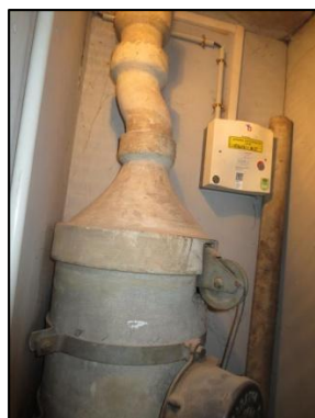
Photo N° 799 AMIANTE CIMENT 6 LORIENT--LOCAL V.O +1 à +8 Vide-ordures Gaine V.O.(Fibres- ciment)
