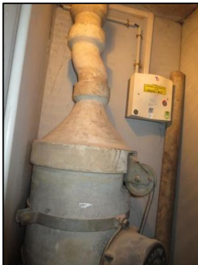
Photo N° 799 AMIANTE CIMENT 8 LORIENT--LOCAL V.O +1 à +8 Vide- ordures Gaine V.O.(Fibres-ciment)
