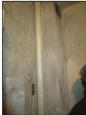
Photo N° 686 AMIANTE CIMENT 8 LORIENT--LOCAL V.O +7 à +8 Conduits de fluide Chute E.P.(Fibres-ciment)
