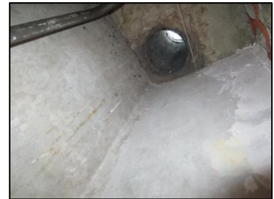
Photo N° 704 AMIANTE CIMENT 8 LORIENT--PLACARDS GAZ +8 Plafonds Ventilation haute (Fibres- ciment)
