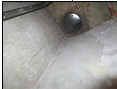
Photo N° 704 AMIANTE CIMENT 9 LORIENT-+1 à +8-PLACARDS GAZ +8 Gains & coffres verticaux Ventilation haute (Fibres-ciment)
