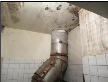
Photo N° 688 AMIANTE CIMENT 9 LORIENT-RDC-LOCAL V.O Vide- ordures Gaine V.O.(Fibres-ciment)
