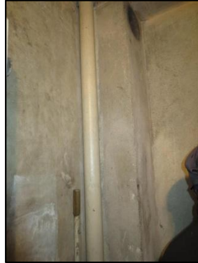
Photo N° 686 AMIANTE CIMENT 9 LORIENT-LOCAL V.O +7 à +8 Conduits de fluide Chute E.P.(Fibres-ciment)
