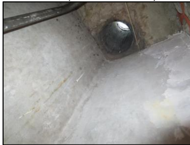
Photo N° 704 AMIANTE CIMENT 9 LORIENT-+1 à +8-PLACARDS GAZ +8 Gaines & coffres verticaux Ventilation haute (Fibres-ciment)
