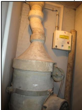
Photo N° 799 AMIANTE CIMENT 11 LORIENT--LOCAL V.O +1 à +9 Vide- ordures Gaine V.O.(Fibres-ciment)
