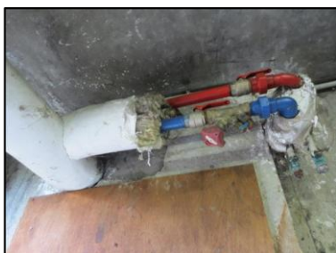
Photo N° 716 ECH-N°10 CALORIFUGEAGE SOUS STATION 11 LORIENT-S.sol-SOUS STATION Conduits de fluide Laine minérale + enveloppe plâtrée
