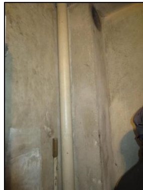
Photo N° 686 AMIANTE CIMENT 12 LORIENT--LOCAL V.O +8 à +9 Conduits de fluide Chute E.P.(Fibres- ciment)
