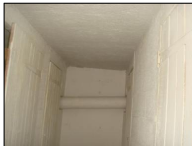
Photo N° 5761 AMIANTE CIMENT 13 LORIENT- s-sol -COULOIRS DE CAVES Murs Ventilation haute (Fibres-ciment)
