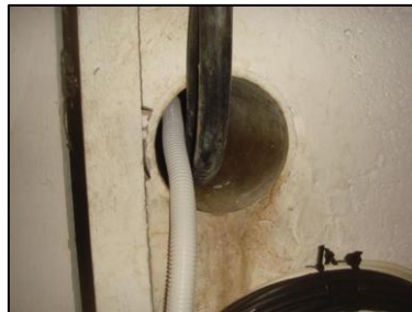
Photo N° 5758 AMIANTE CIMENT 13 LORIENT-S-SOL-COULOIRS DE CAVES Murs Fourreau
