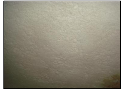
Photo N° 5759 ECH-N°14 FLOCAGE 13 LORIENT-S.sol- COULOIRS DE CAVES Plafonds flocage
