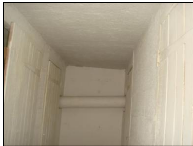
Photo N° 5761 AMIANTE CIMENT 13 LORIENT-S.SOL-COULOIRS DE CAVES Murs Ventilation haute (Fibres-ciment)
