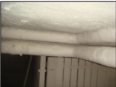
Photo N° 5760 ECH-N°13 CALORIFUGEAGE 13 LORIENT- S.SOL-COULOIRS DE CAVES Conduits de fluide Laine minérale + enveloppe plâtrée
