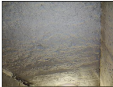
Photo N° 72 ECH-N°1 FLOCAGE S.sol 1 Plafonds Cotonneux blanc
